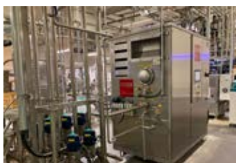
茨城工場に設置したエアピグ装置
