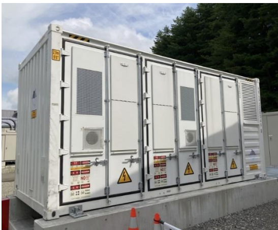
富士見工場に導入した蓄電池システム
