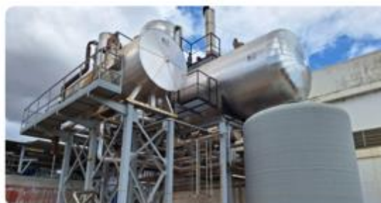
Italagro社の温水の回収タンク
