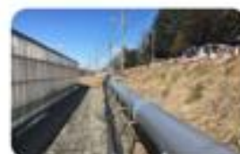
工場の排CO2を菜園に送る配管
